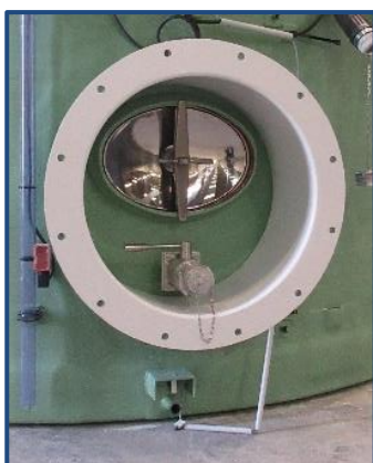
Double porte étanche permettant l'accès à la pompe
